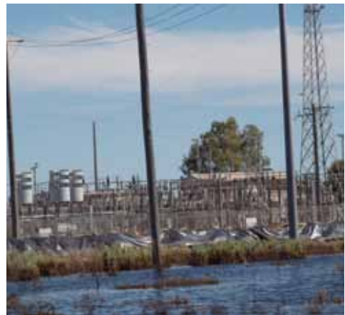
Central eléctrica anegada por el agua.
